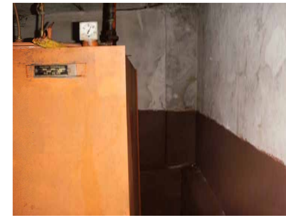
Foto Nr.5: Heizöltank im Keller
