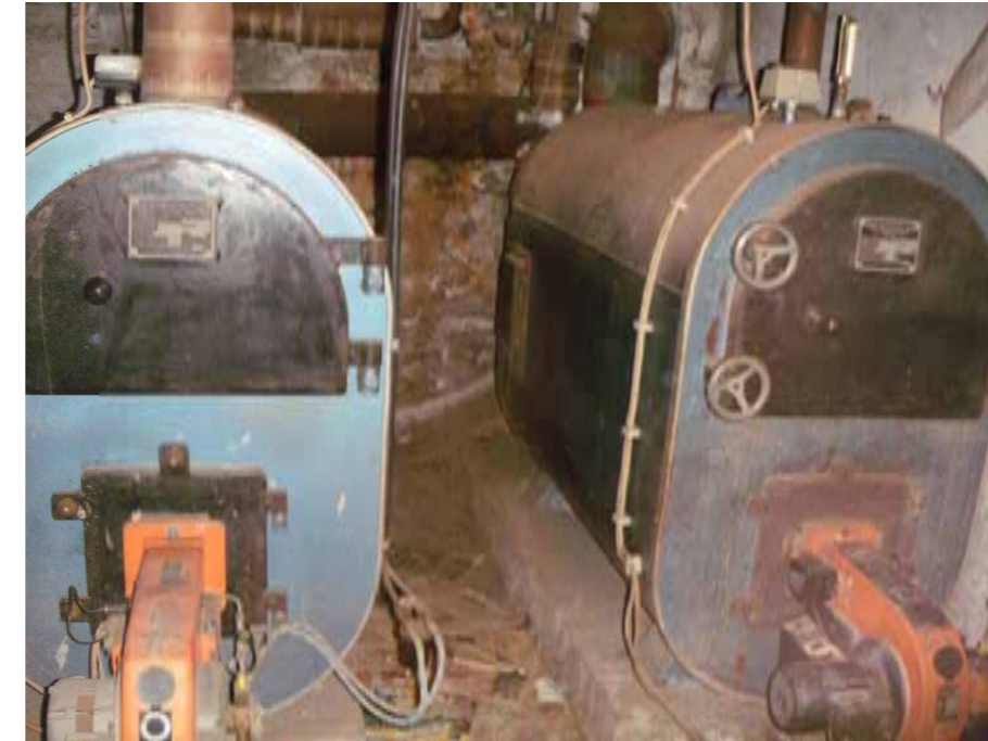
Foto Nr.8: Heizungsanlage
