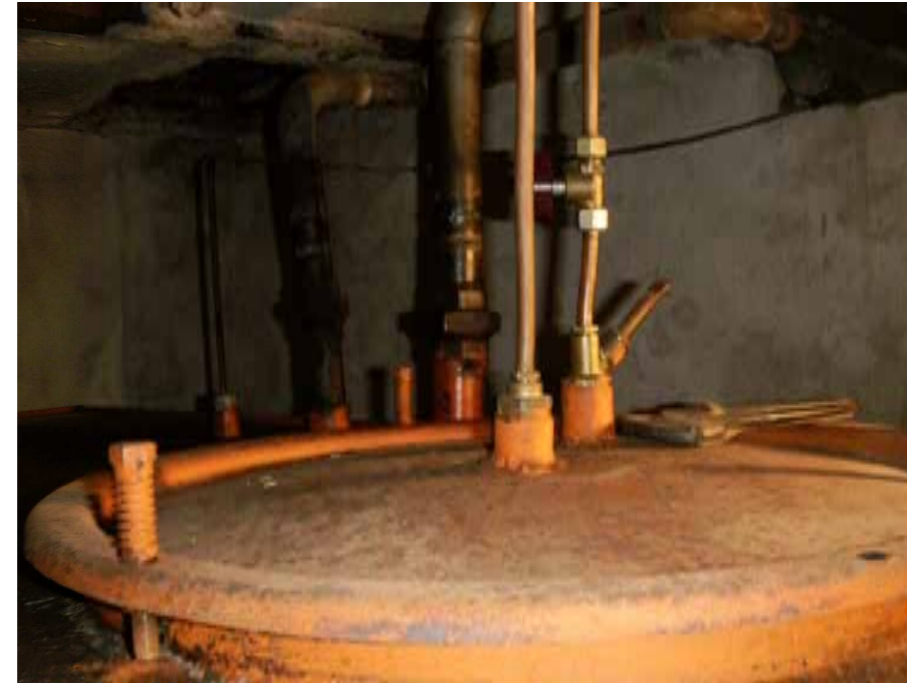
Foto Nr.7: Anschlüsse Heizöltank
