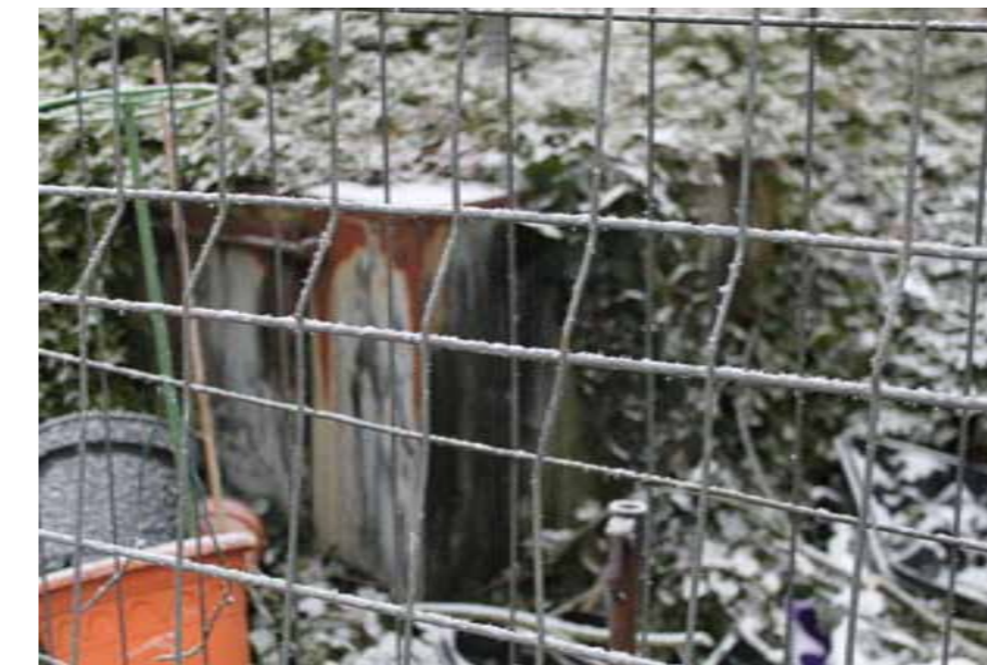
Foto Nr.9: Heizöltank vor Gewächshaus V
